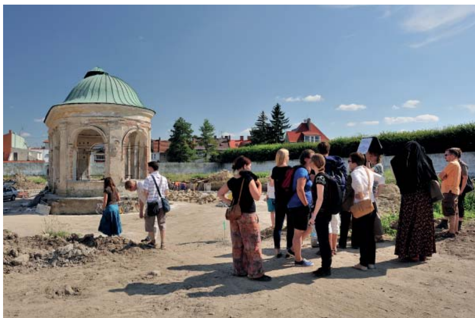
Na snímku nahoře: Právě letní teploty a stavební práce v plném proudu tvořily kulisu 6. analýzy projektu památkové obnovy přímo v areálu kroměřížské Květné zahrady.
